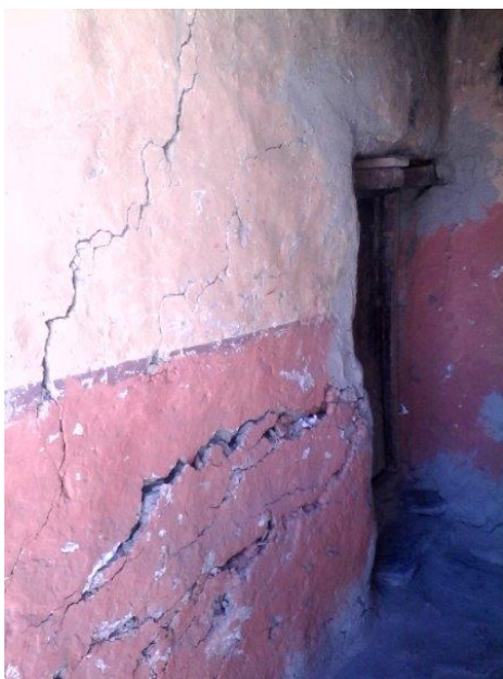
Tsosher: Schaden durch das Erdbeben
